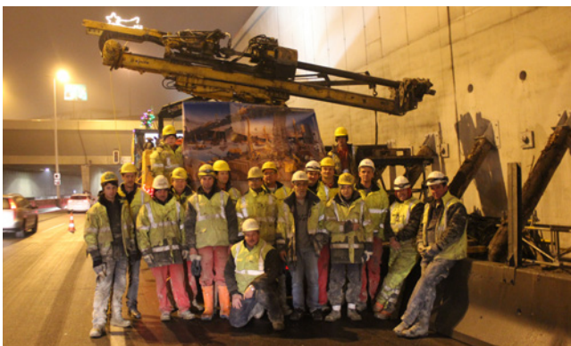
6.1.2: Nur vier Monate brauchte das Team am Laaerberg, um 800 bis zu 18 m lange Anker in die Stützmauern der A23 einzubauen.
