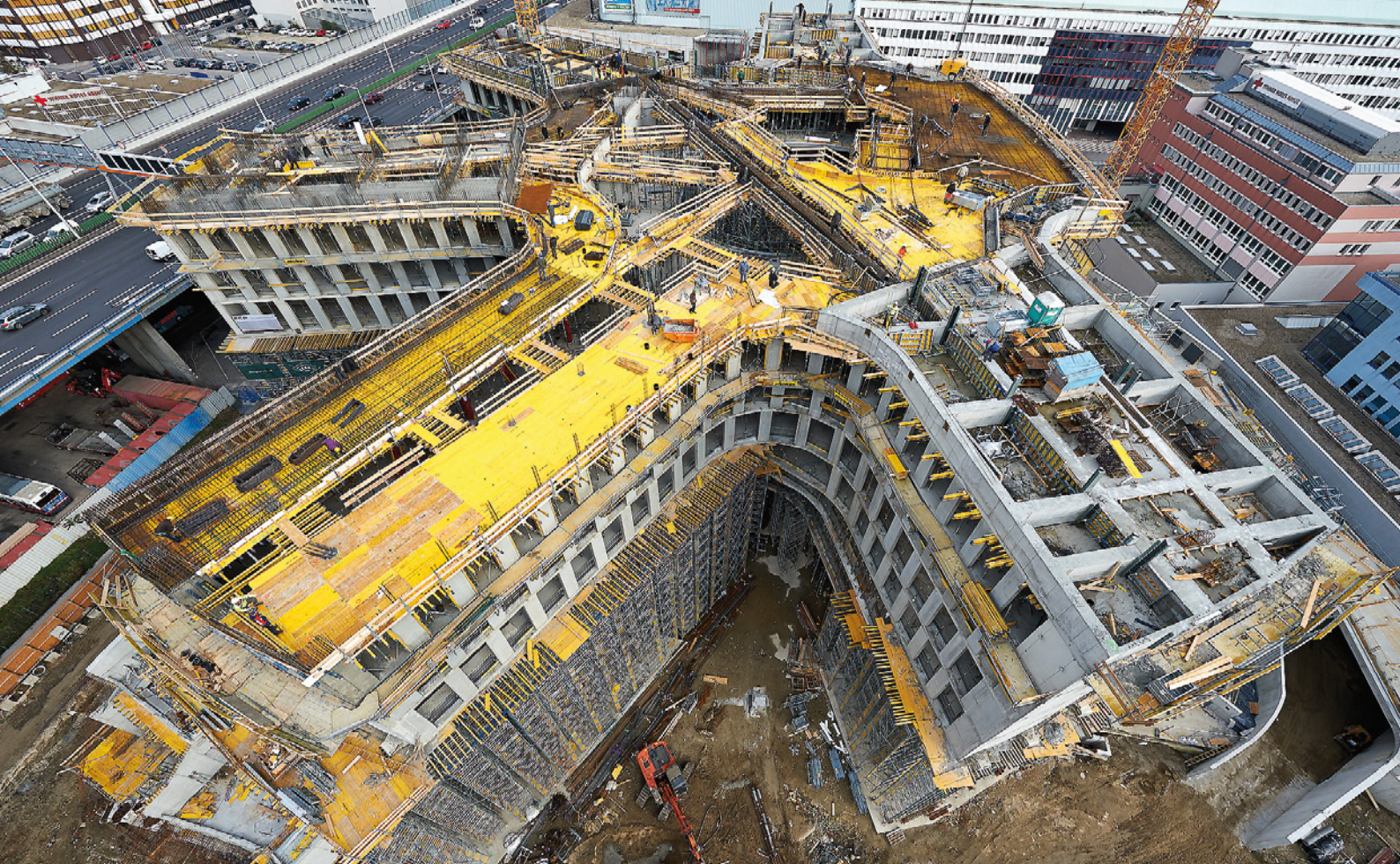
4.1.1: Bei der neuen ÖAMTC-Zentrale in Wien ruhen die fünf scheinbar schwebenden Bürofinger jeweils auf sechs Schrägstützen.
