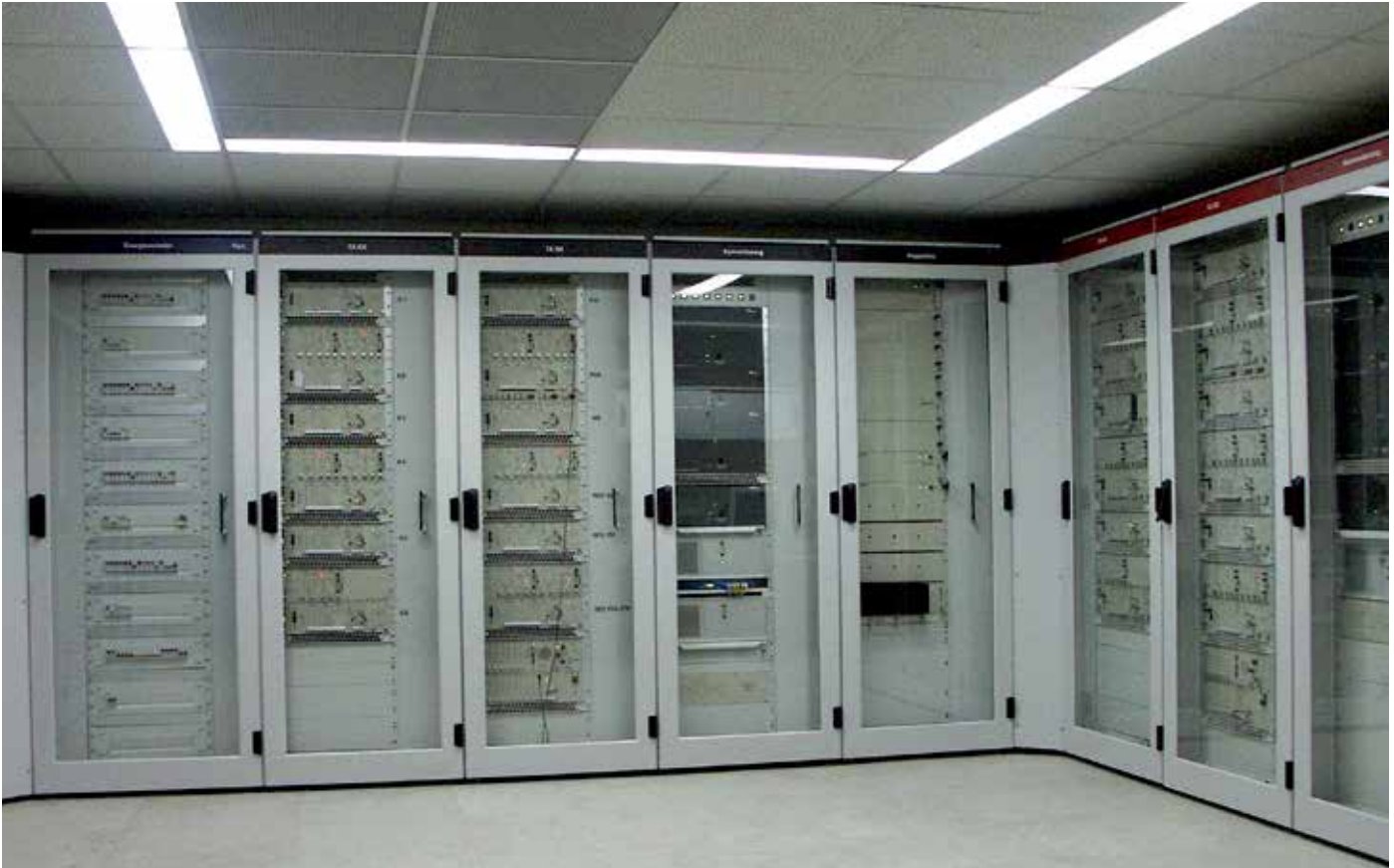
Vor allem bei technisch aufwendigen Gebäudeausrüstungen, wie etwa Serverräumen, hilft die Schnittstellenmatrix, die unterschiedliche Lebensdauer von TGA und Bauwerk in der Planung zu berücksichtigen.
